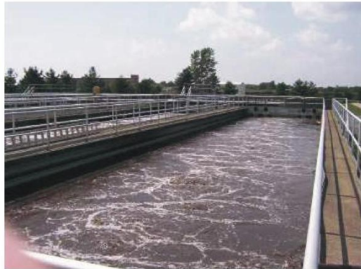
บ่อบำบัดน้ำเสีย
