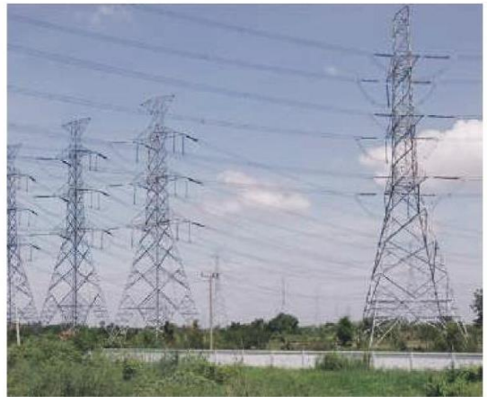
เสาไฟฟ้า
